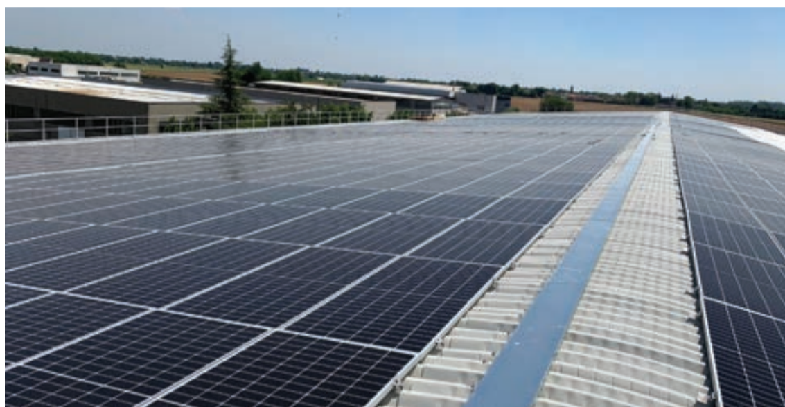
UN IMPIANTO REALIZZATO DA LG SOLAR IN PROVINCIA DI PIACENZA CON 1.300 MODULI FOTOVOLTAICI MONO X PLUS DA 450 WP, PER UNA POTENZA COMPLESSIVA DI 600 KWP
