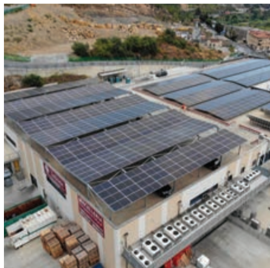
UN IMPIANTO FOTOVOLTAICO REALIZZATO SUI TETTI DI UN'AZIENDA DI IMPERIA. LA COPERTURA OSPITA IL PARCHEGGIO AUTO. PER QUESTO RCM HA REALIZZATO STRUTTURE DI SUPPORTO PER PENSILINE FOTOVOLTAICHE
