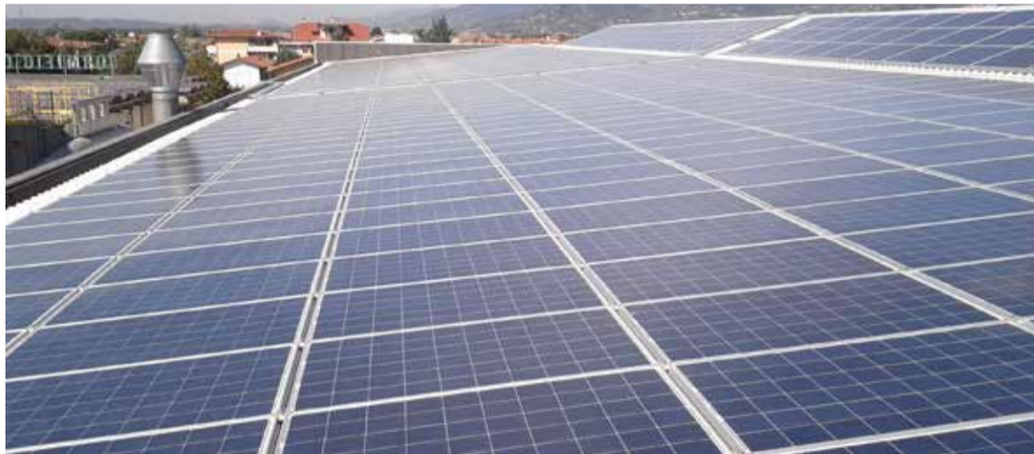
L'IMPIANTO FOTOVOLTAICO DA 128 KWP ERA STATO INSTALLATO NEL 2011 IN SOSTITUZIONE ALLA COPERTURA IN AMIANTO
