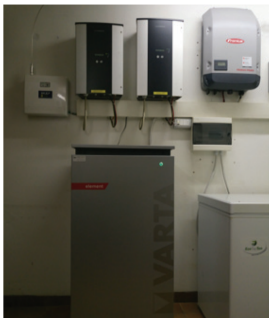
IL SISTEMA DI ACCUMULO VARTA ELEMENT 9, INDICATO PER INTERVENTI DI RETROFIT, È STATO INSTALLATO SUL LATO AC
